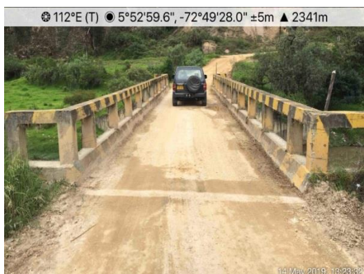
Fotografía 3-19 Puente sobre el río Chicamocha: En buenas condiciones, pero requiere reemplazo de barandas para paso de cargas
