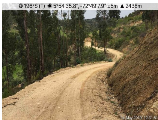
Fotografía 3-21 Punto para revisión de diseño geométrico por posible incumplimiento de longitudes mínimas de alineamientos
