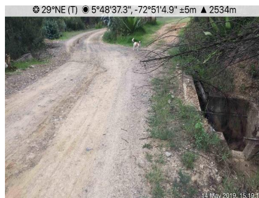
Fotografía 3-8 Vía en afirmado (material muy fino), con obras de drenaje longitudinal y transversal sin mantenimiento
