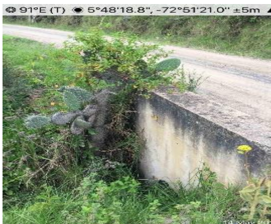
Fotografía 3-9 Alcantarillas parcialmente obstruidas por vegetación y sedimentos, generando pérdida de la capacidad hidráulica de la estructura
