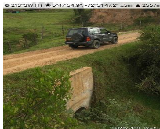
Fotografía 3-10 Capa de rodaduras que requiere en varios tramos la instalación de material de afirmado en longitud total superior a 1.0 km, con espesor y ancho variable
