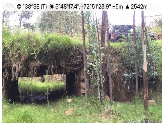
Fotografía 3-7 Pontones construidos en madera que deben ser reemplazados para tránsito de cargas de taladro
