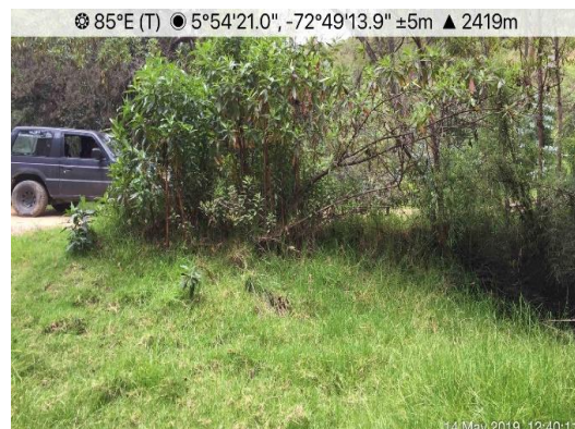
Fotografía 3-24 Puente con estructura en troncos de madera y estribos en concreto, se recomienda cambiar la estructura completa
