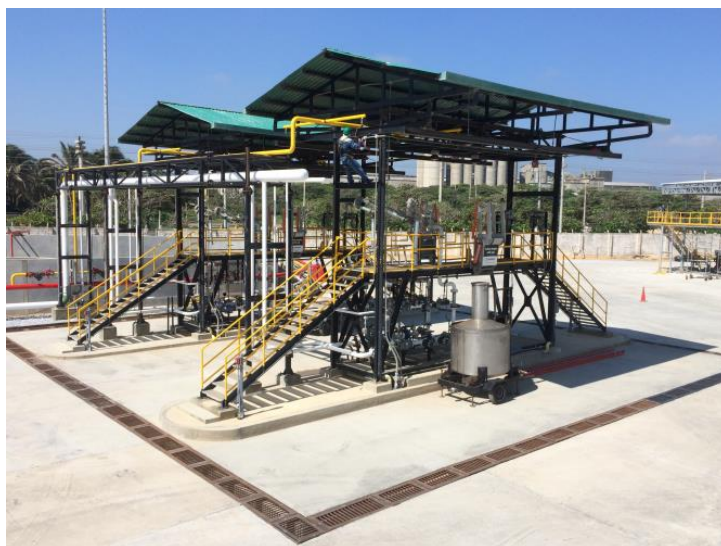
Figura 3-89 Cargadero de crudo
