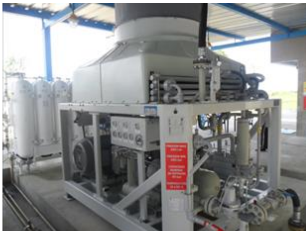
Figura 3-84 Compresor de gas de 2 etapas (220 hp)
